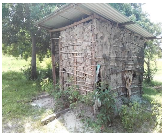
Etat des latrine à l'EP Nana
