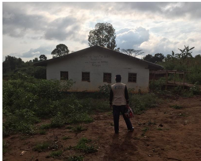
Etat actuel de CS JIBA, pillé le 18 juillet 2019 par les éléments de la FARDC
