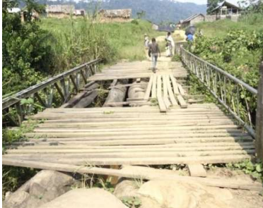
Pont reliant le quartier Bushimoo, groupement Bashali Mokoto au quartier Katanga, groupement Ihana, en direction du village Katanga, axe Pinga – Lukweti, en état de détérioration avancé ; Unique passage pour se rendre à Bukonde
