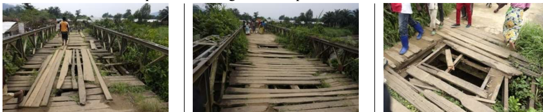
Le pont reliant le quartier Nkassa du groupement Kisimba au quartier Bushimoo, groupement Bashali Mokoto, en état avancé de détérioration, unique accès pour se rendre dans le quartier de Bushimoo – Photos prises le 21 Août 2019
