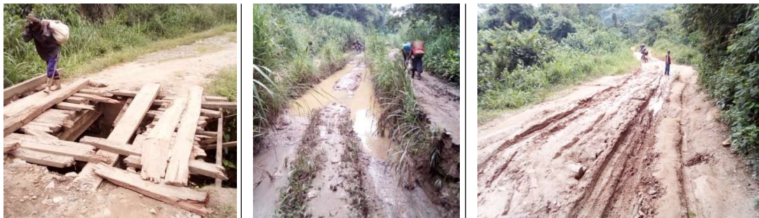
Axe Mpeti – Pinga – Détérioration importante de la route – Photos prises le 20 Août 2019
