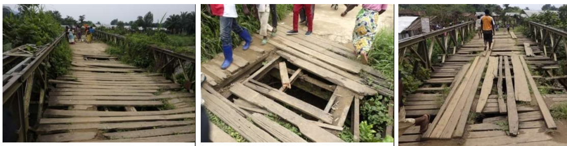
Le pont reliant le quartier Nkassa du groupement Kisimba au quartier Bushimoo, groupement Bashali Mokoto, en état avancé de détérioration, unique accès pour se rendre dans le quartier de Bushimoo – Photos prises le 21 Août 2019
