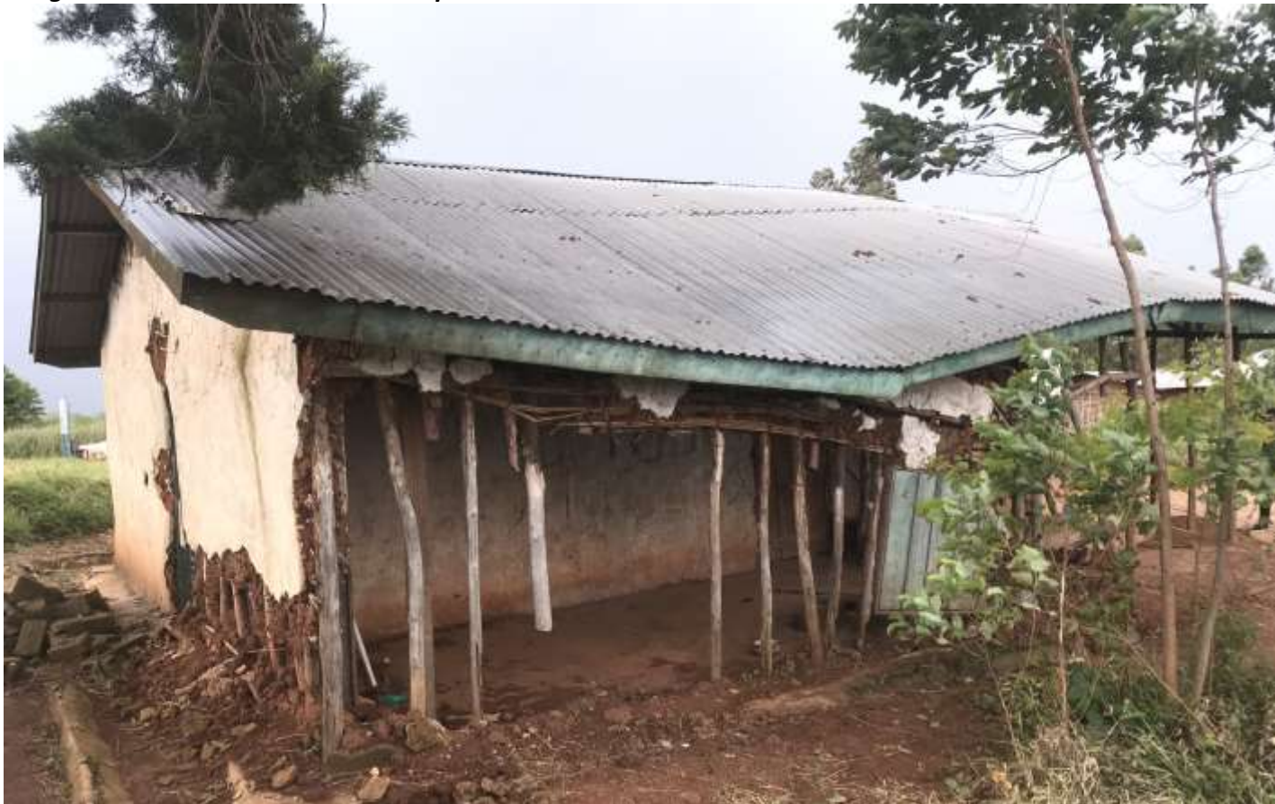
Image 1 illustrant le bâtiment du dispensaire du CS en délabrement avancé
