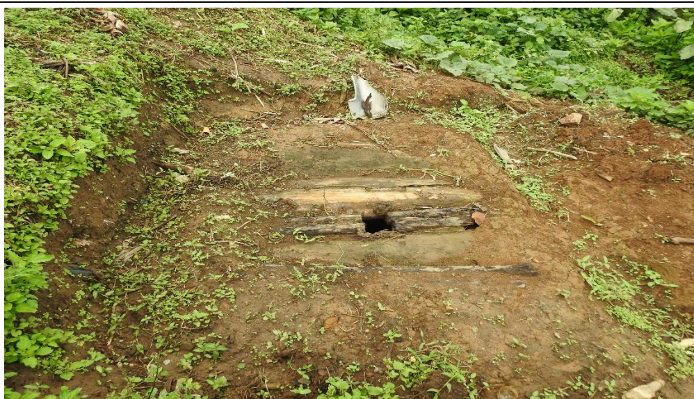
Figure 8: état d'une latrine à ciel ouvert dans la zone sans superstructure
