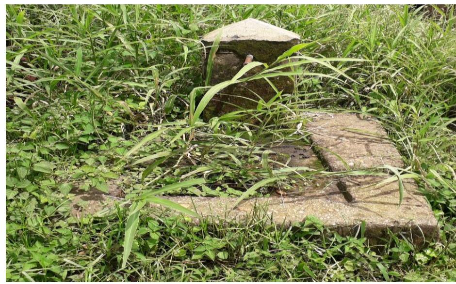
Figure 7: état d'une Borne fontaine dans la zone
