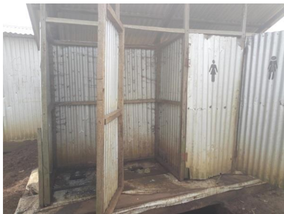
Les latrines dans le camp de déplacés à Kizimba
