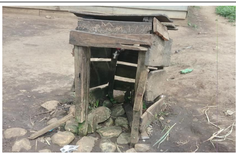
Figure 4: Etat d'un robinet non fonctionnel à Nyabiondo
