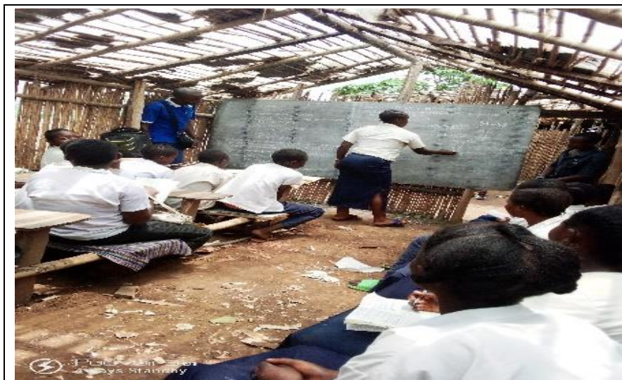
Figure 5: Etat d'une école de Nyabiondo
