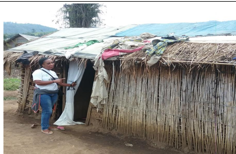
Figure 2: Etat d'un abri à Nyabiondo
