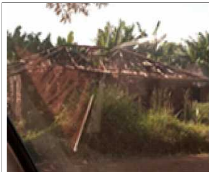
Les séquelles des conflits interethnique : les destructions méchantes des abris à Kabanda
