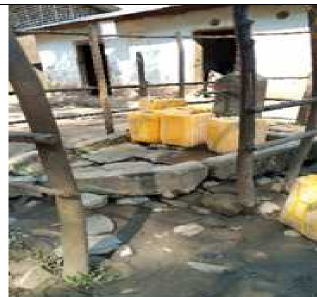
BF en délabrement à Kashalira.
