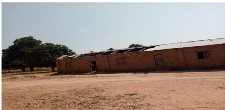
EP Kyona avec une partie de la toiture emportée
