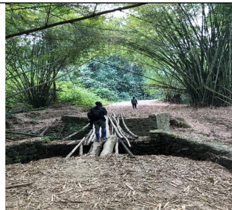
Etat du pont sur la Route nationale N°2, Axe KITUTU-KITINDI Territoire de SHABUNDA SK RDC © YODI, UNHCR, aout 2020
