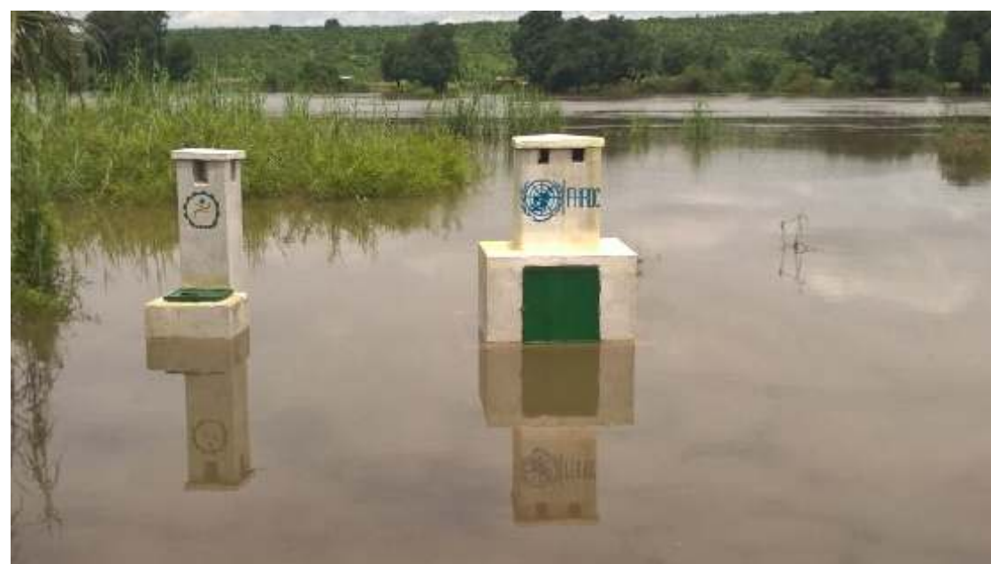
Ouvrage d'Assainissement de l'AS MEDICO Social du « Projet Standard choléra 2019 (CENEAS FH-RDC) » Inondé.
