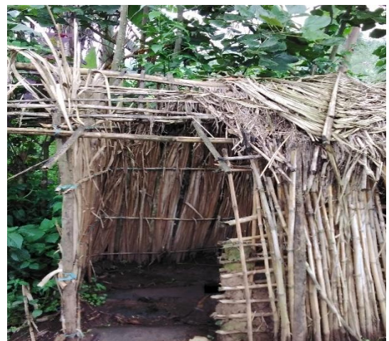
Etat d'une latrine à Lukweti, le 07 Octobre 2020
